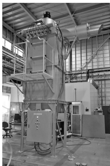
写真5 バグ型集塵機
